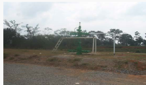
Injection well Sitio Grande 801
