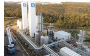
CS Energy - AU (Coal)
